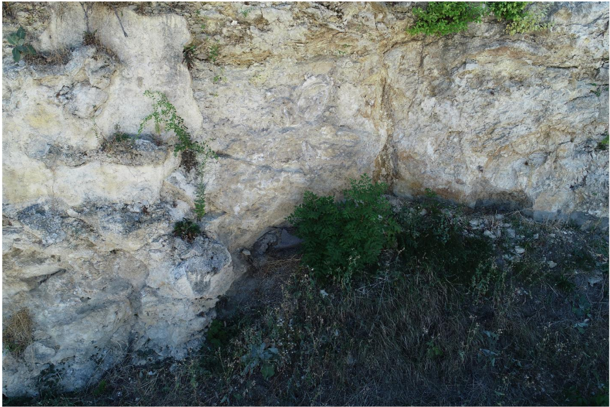
Слика 39. Сегмент 2 – изворна слика удубљење са пукотином
