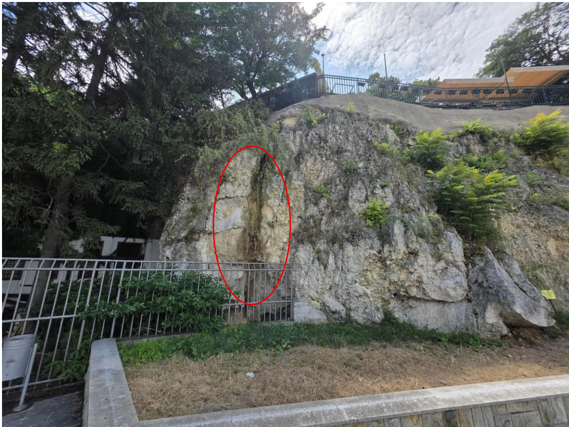
Слика 3. Приказ оштећења насталих на стенском одсеку
