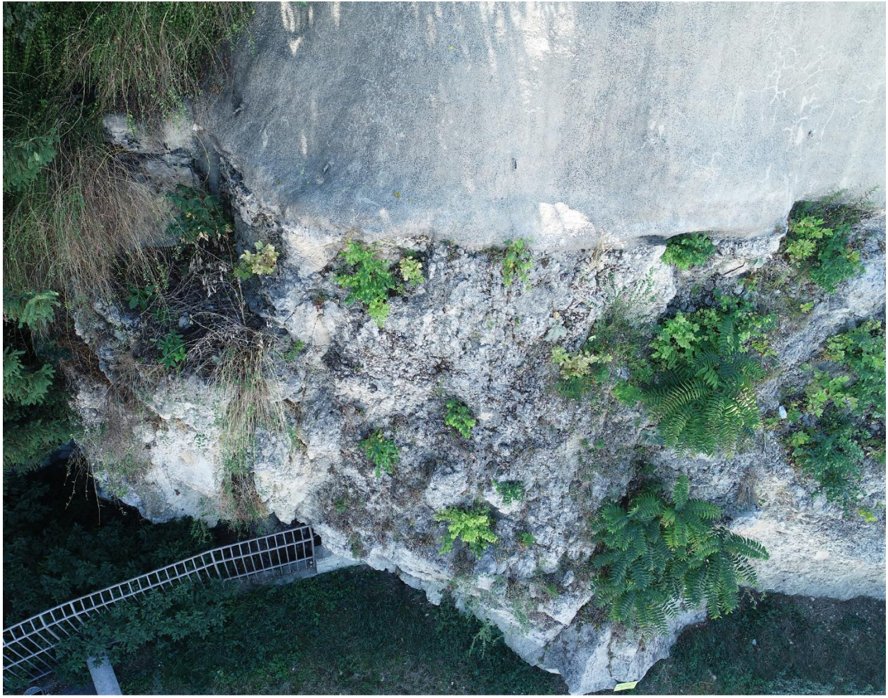
Слика 20. Изворна слика изнад „колектора“ и пукотине
